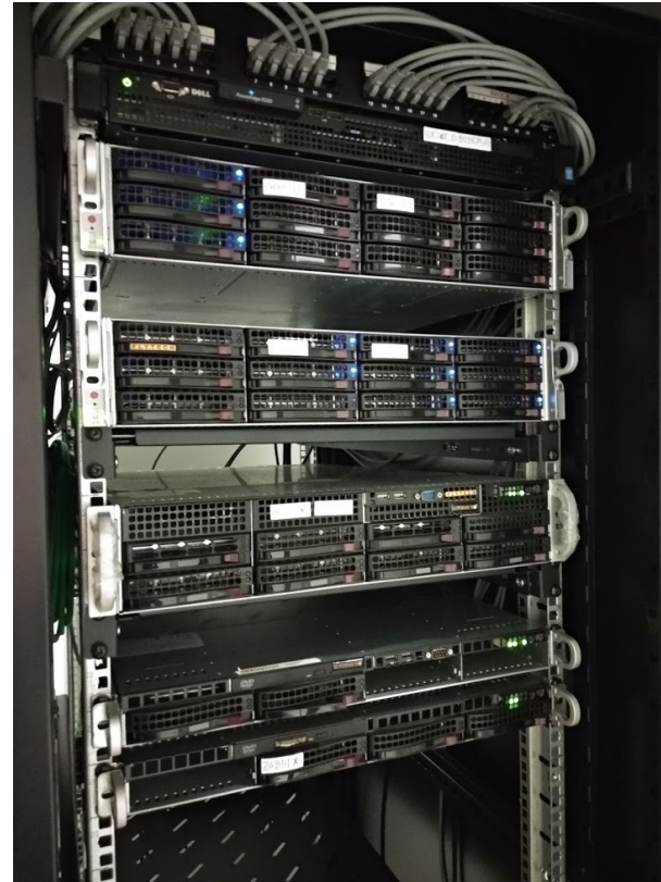
Servidores en RACK
